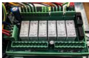
Scheda di controllo elettronica Electronic PC board
